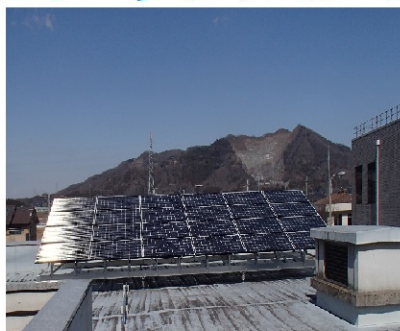
★太陽光発電設備施工例★
